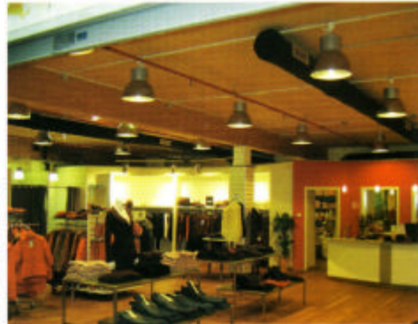
Bild 9 Ist doch netter als nur Beton, für's gleiche Geld. Architektonisch wäre vielleicht noch eine diskretere Besprinklerung zu entwickeln, ein bisschen stört das schon (unter Beton fällt es wahrscheinlich weniger auf).
