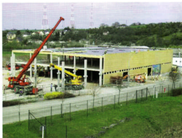
Bild 2 Auf den ersten Blick eine Holz-Beton-Baustelle, das könnte zu einem normalen Anblick werden.
