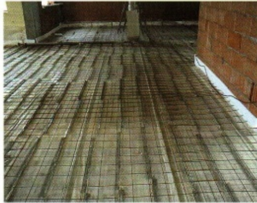
Bild 2: Die BS-Holz-Fladen vor dem Aufbringen des Betons; betoniert wurde nach dem vollständigen Richten.
