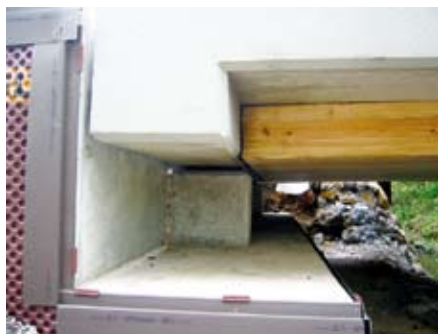
Bild 11 Auflagerdetail der HBV-Brücke in Kayl. Lagerung des querlaufenden Stahlbetonauflegerbalkens über Elastomerlager auf dem Widerlager.
